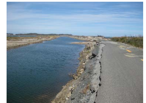
相馬市 松川浦湖岸堤防被災状況
