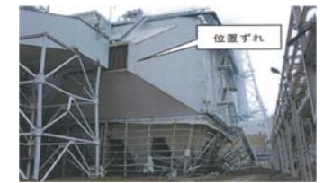
電気集塵機被災状況
