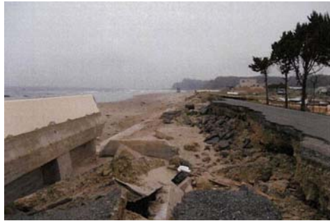
いわき市 豊間漁港海岸堤防被災状況
