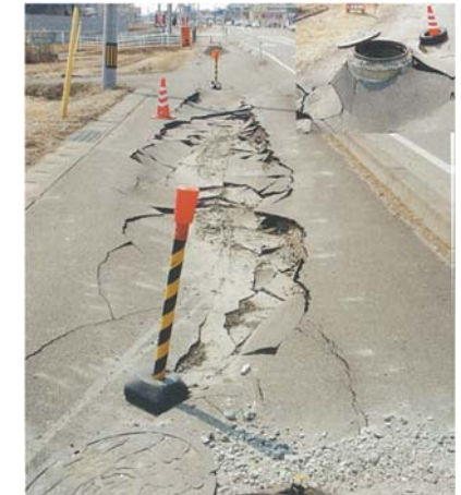
管路施設の被災状況（矢吹町 H23.3.25）
