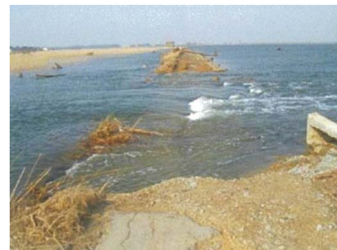
出展：福島県 相馬市 松川浦湖岸堤防被災状況
