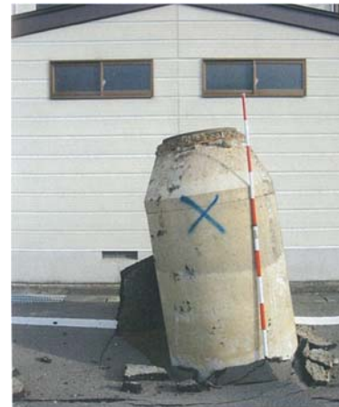
マンホールの被災状況（国見町 H23.3.14）
