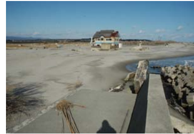
浪江町 中浜海岸堤防被災状況
