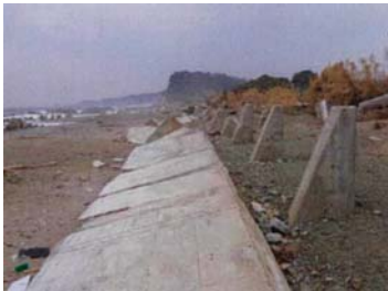
広野町 浅見川海岸堤防被災状況
