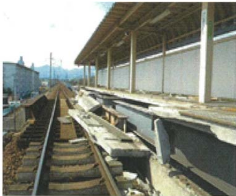
福島学院前駅被災状況
