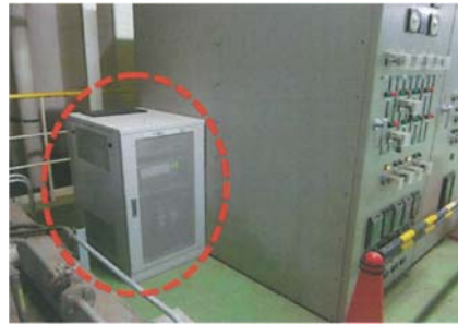
非常用GT発電機制御電源の無停電電源装置
