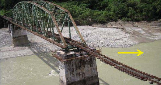
被災状況 2011.8.24撮影
