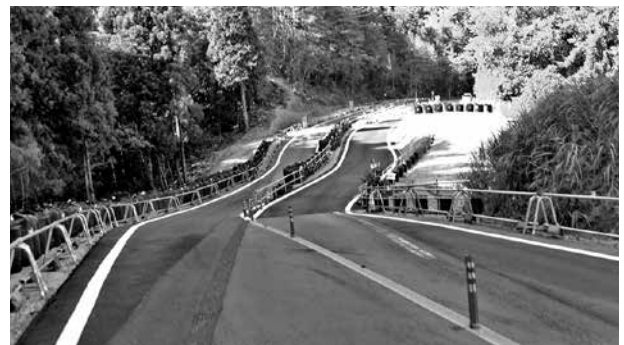
写真1. 被害が激しい能越自動車道
